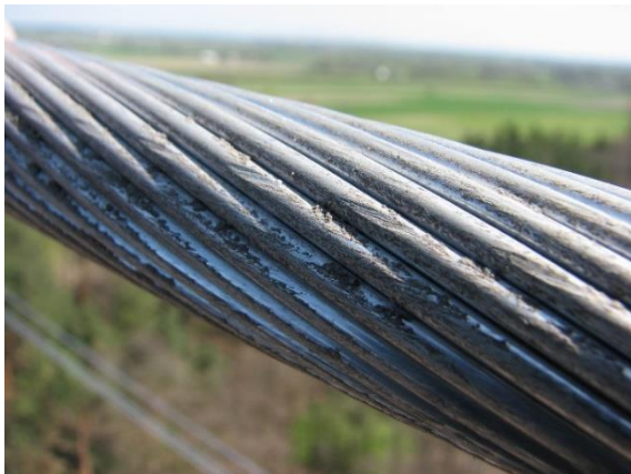
Rys. 2c. Widok uszkodzonych drutów warstwy zewnętrznej – zanieczyszczenie
