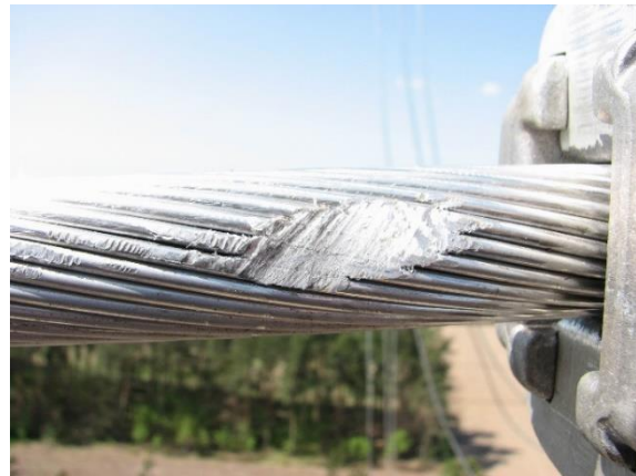
Rys. 2b. Widok uszkodzonych drutów warstwy zewnętrznej – przetarcie
