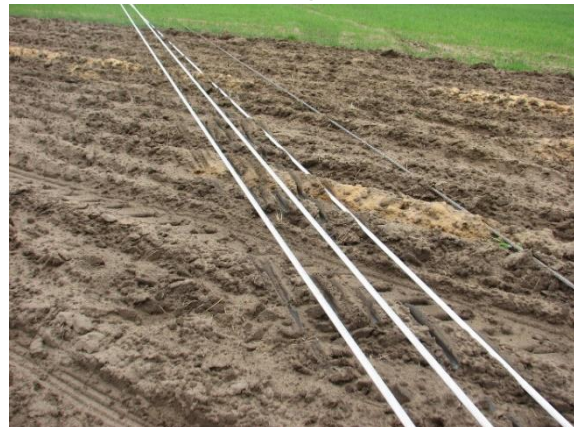
Rys. 2d. Niewłaściwy montaż przewodów
